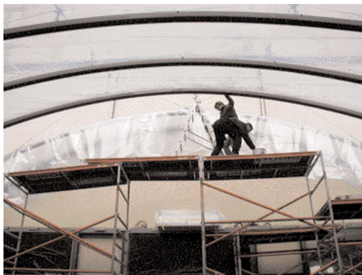
2 instalace ETFE polštářů do AL profilů osazených na nosné konstrukci z profilů H
