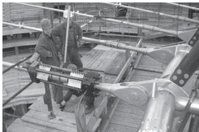
Obr. 2 – Hydraulické zařízení technotensioner poprvé u nás použité na Sazka aréně
