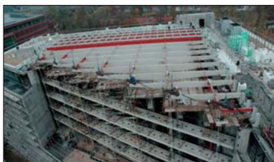
Obr. 6 – Nile House (statika Pars Building, předpínání Excon, VSL, UTAM AV ČR, Hutní montáže).
