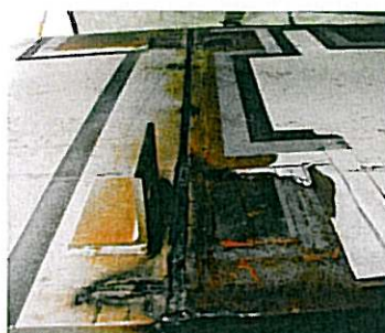
Obr. 12 – Spára zavařená v rozích.
