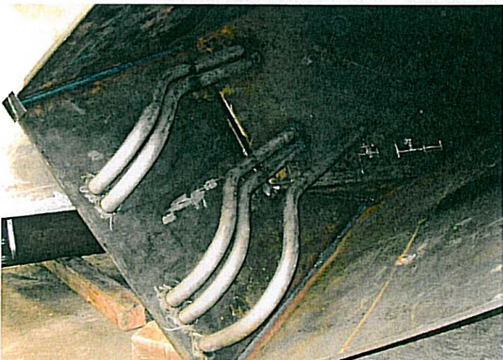
Obr. 5 – Detail křížení s vevařenými chráničkami z korozivzdorné oceli.
