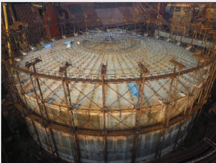
▲ Zdvih zvonu plynojemu – cca polovina výšky zdvihu (+6,5 m)
