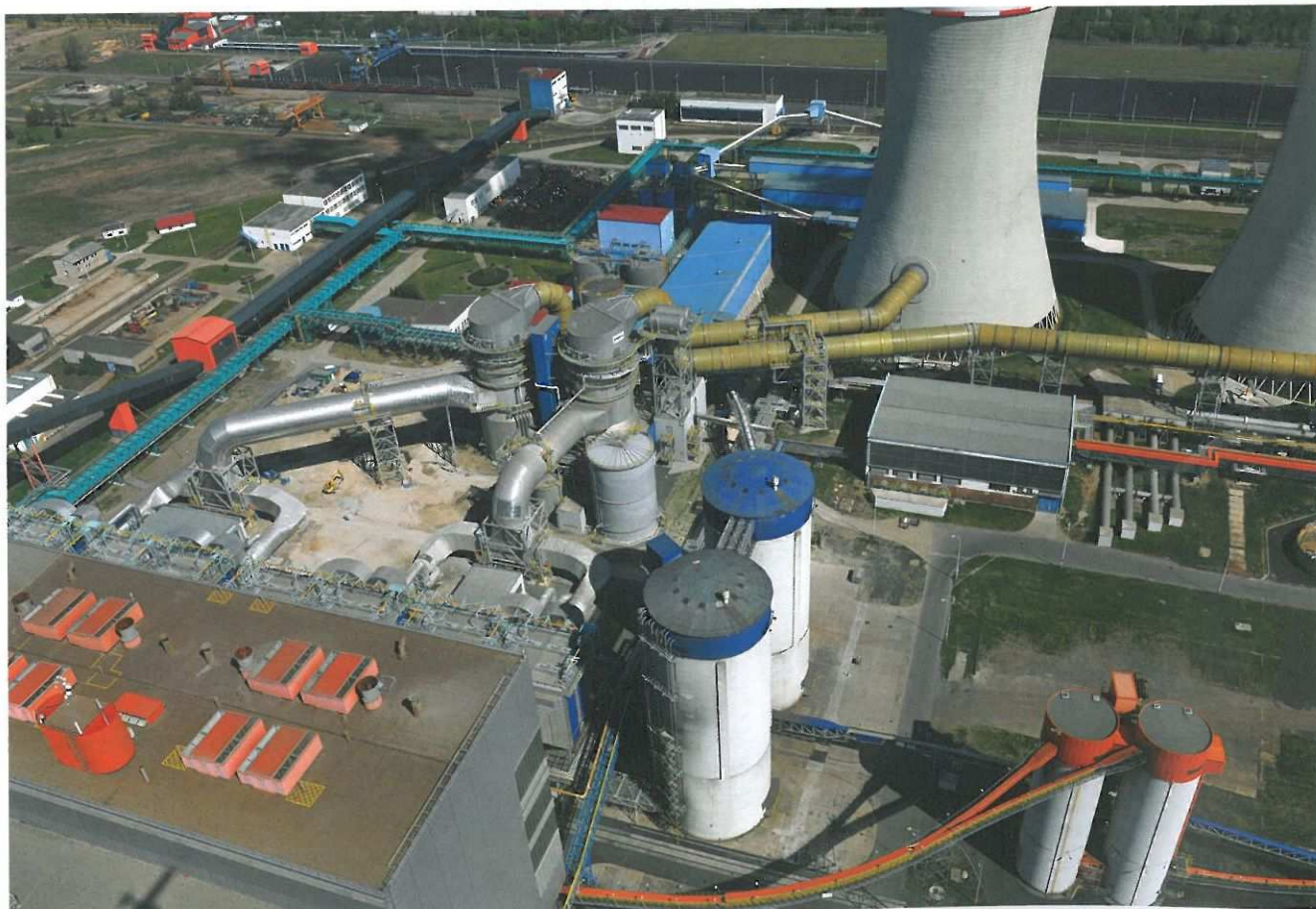
Pohled na technologii odsíření
