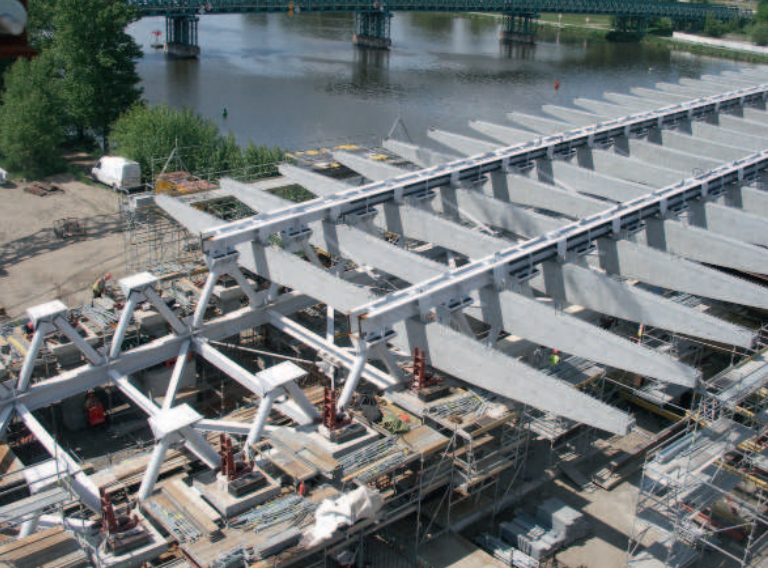
▲ Obr. 3. Výrobna a část vysunutého roštu
