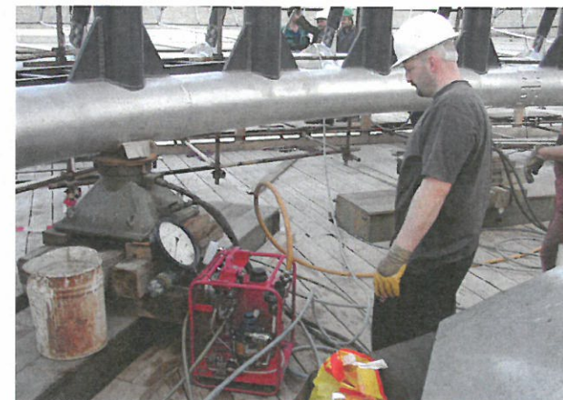
Hydraulické zařízení pro předpínání a jeden z 12 zvedáků na kterých byl tubus uložen
