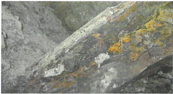
▲ Obr. 22. Zemní táhlo 1C na IV. nástupišti po odkrytí – detail nad vstupem táhla do betonového základu. Jedná se o místo s největším korozním poškozením, cca 70%.
