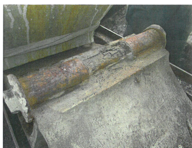
▲ Obr. 11. Kloubové ložisko po demontáži patky sloupu 1C na IV. nástupišti
