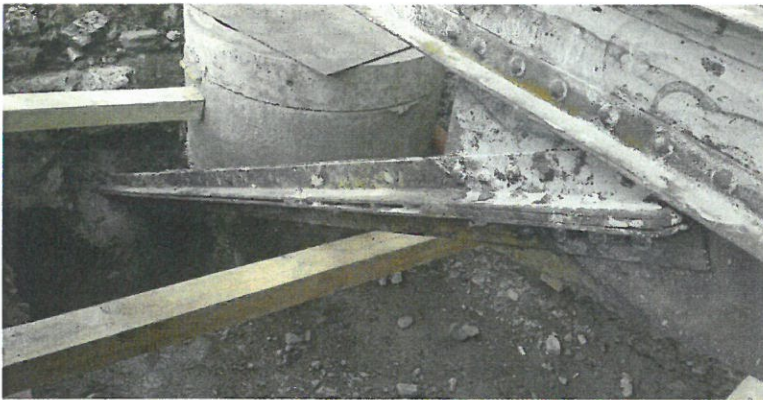
▲ Obr. 21. Zemní táhlo 1C na IV. nástupišti po odkrytí – stav před výměnou
