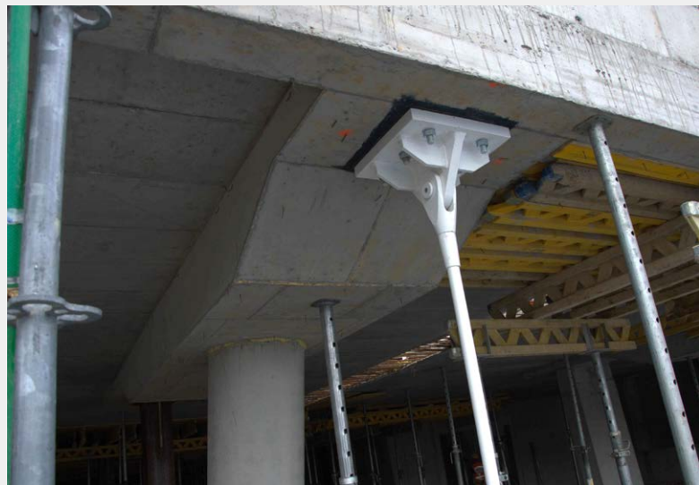
▼ Obr. 3 Šikmý sloup podpírající průvlak se závěsem Macalloy M42 ve 2.NP
