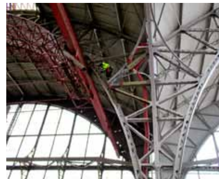
Obr. 6: Nevyhovující diagonála na III. nástupišti
