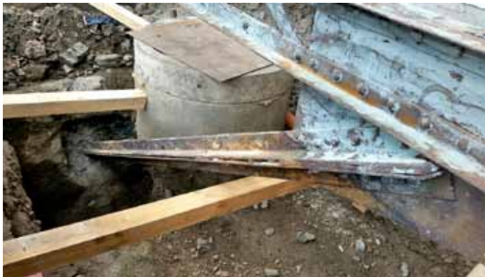
Obr. 23: Zemní táhlo 1C po odkrytí – stav před výměnou
