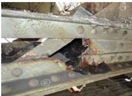
Obr. 7, 8: Korozní poškození spodního pasu příčné vazby
