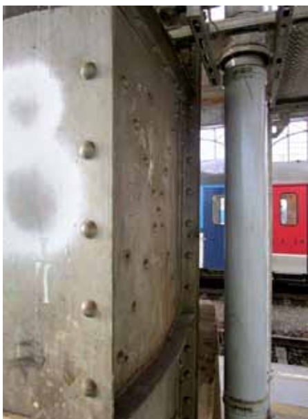
Obr. 11: Vyboulení stěn sloupů na III. nástupišti
