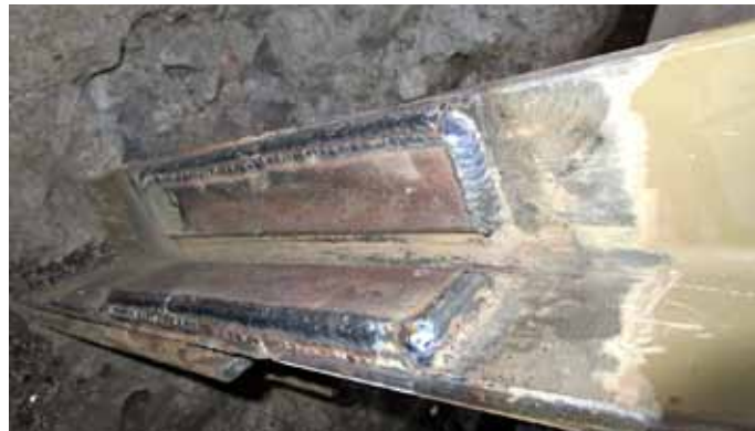
Obr. 24: Zemní táhlo 1C – detail místa s největším korozním poškozením (cca 70 %) po opravě
