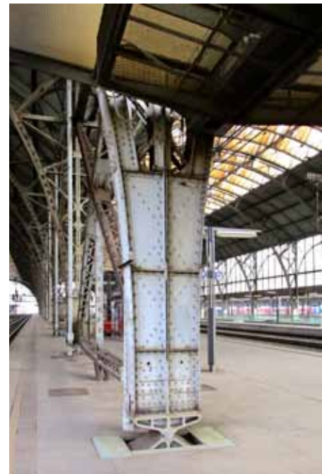
Obr. 18: Poškozený sloup 1B
