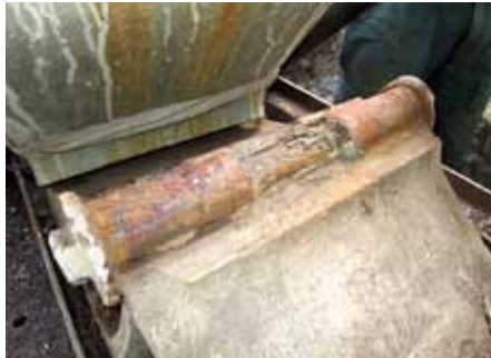
Obr. 15: Kloubové ložisko po demontáži patky sloupu
