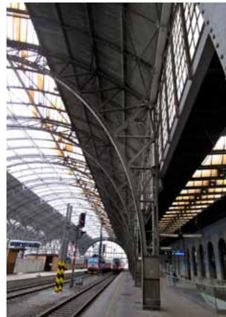
Obr. 5: Nevyhovující diagonála na IV. nástupišti
