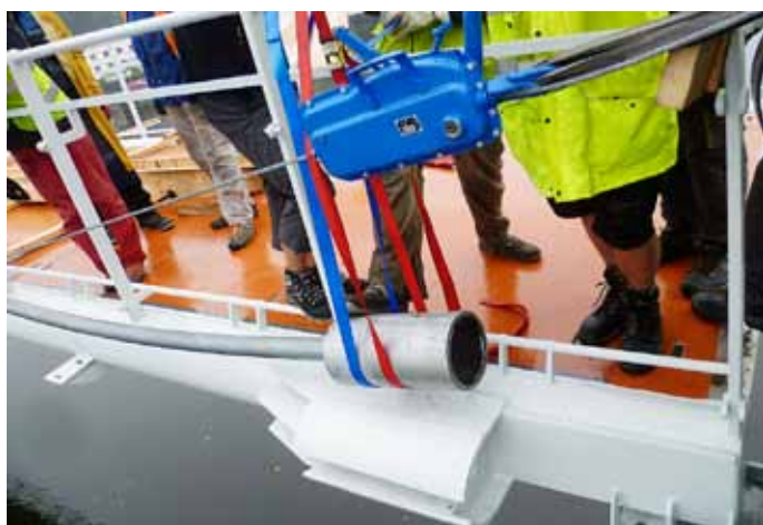
Obr. 10: Montáž válcové koncovky do boční výztuhy na horním pasu tělesa visuté lávky
