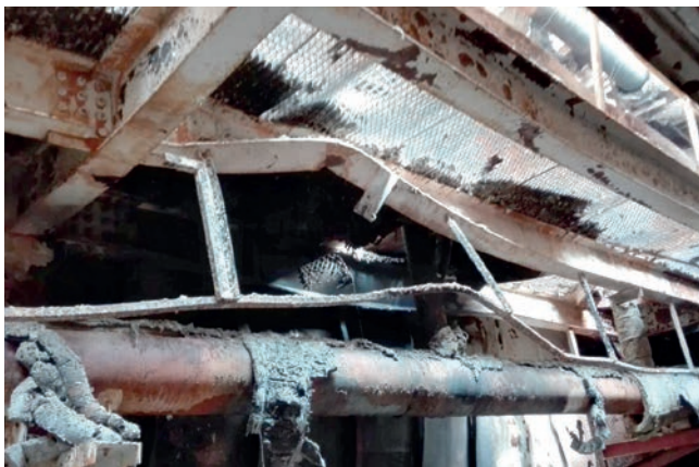
Poškozená nosná ocelová konstrukce na úrovni +16,1 metru
