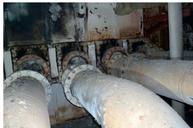
Poškozené technologické potrubí před demontáží
