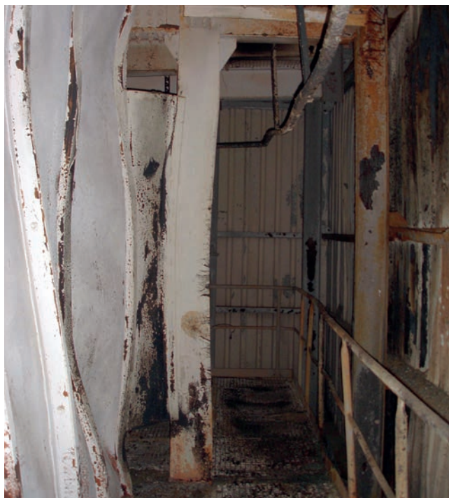
Poškozená nosná ocelová konstrukce na úrovni +16,1 metru – sloup nosné ocelové konstrukce budovy ABS, poškození pláště tělesa ABS1 na úrovni +16,1 metru
