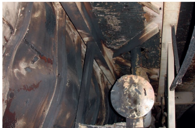
Poškození pláště tělesa ABS1 na úrovni +16,1 metru
