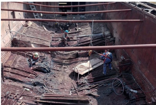
Poškozená technologie pro přehřívání spalin na úrovni +23 metru; zařízení bylo v blízkosti epicentra požáru
