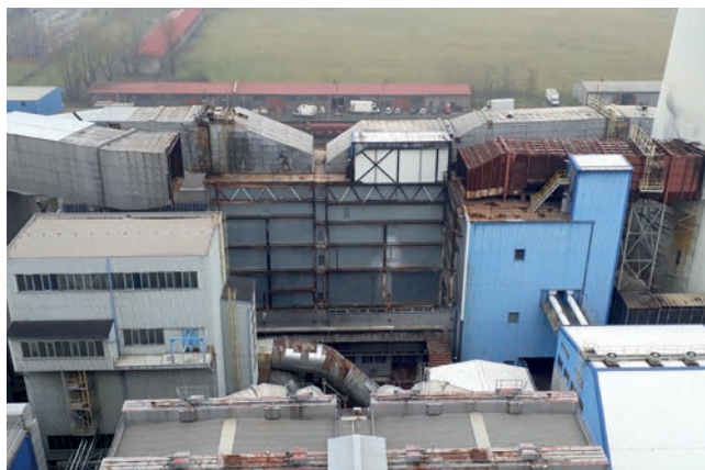
Celkový pohled, stav objektu po dokončení demontáží poškozených konstrukcí ABS1
