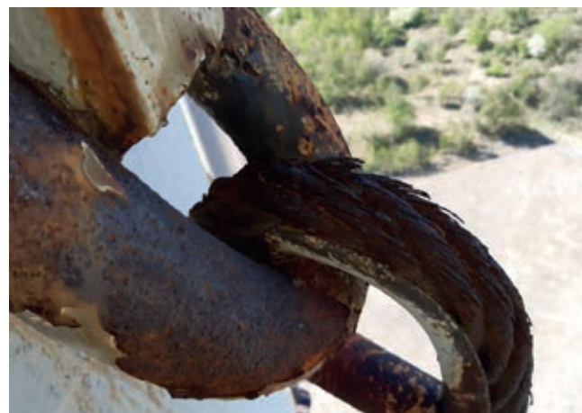
Obr. 4 – Koroze kotevního lana
