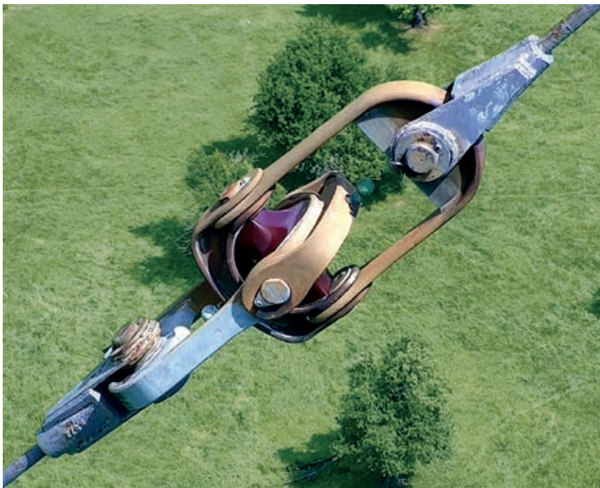
Izolátor kotevnických lan.
