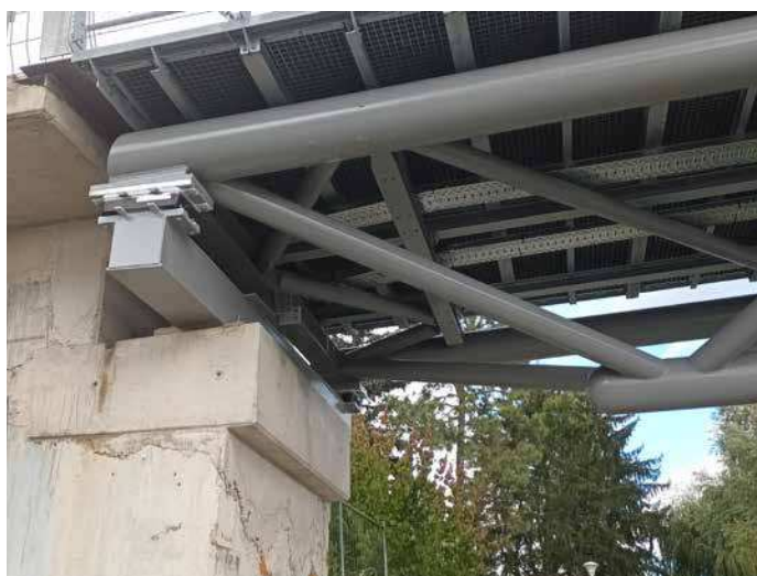
▲ Obr. 4 Uložení na ložiskách přes rozšiřující příčník na radotínské opěře (O1)
