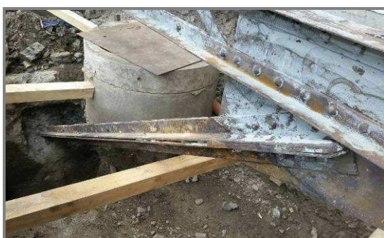
Obr. 33 Zemní táhlo 1C po odkrytí – stav před výměnou Figure 33 Anchor bar 1C after exposure condition before replacement
