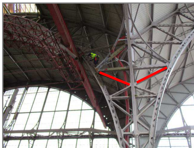
Obr. 07 Nevyhovující diagonály na III.nástupišti Figure 07 Unsatisfactory diagonal members on platform III
