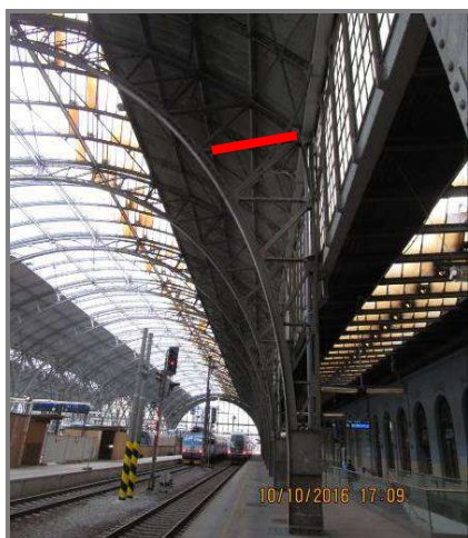
Obr. 06 Nevyhovující diagonála na IV.nástupišti Figure 06 Unsatisfactory diagonal member on platform IV
