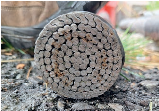
Obr. 2 – Řez původním kotevním lanem.
