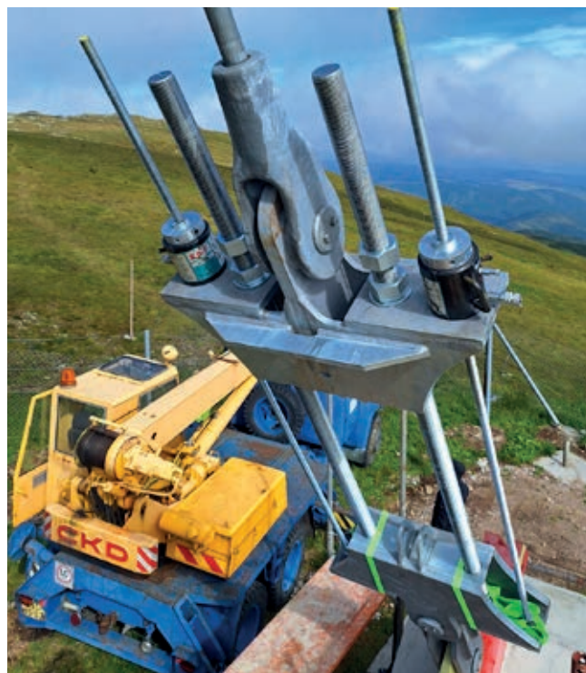
Obr. 5 – Nové napínací zařízení s osazenými hydraulickými lisy.
